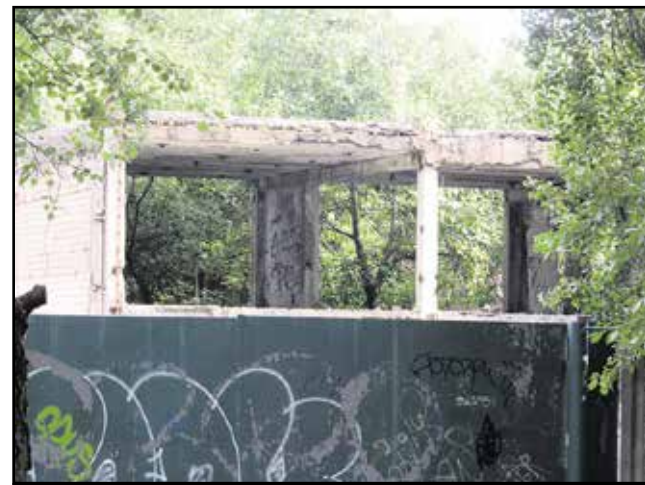
На фото: разрушенный детский сад, пр-т Ак. Глушко, 17/2
